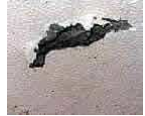
局部的損傷、欠損
