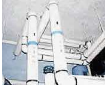
吸音・断熱材 機械室の壁・天井
